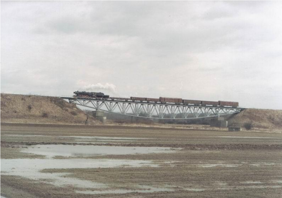
most nad rzeką Osobłoga, który został uszkodzony w ramach AKCJI MOSTY
